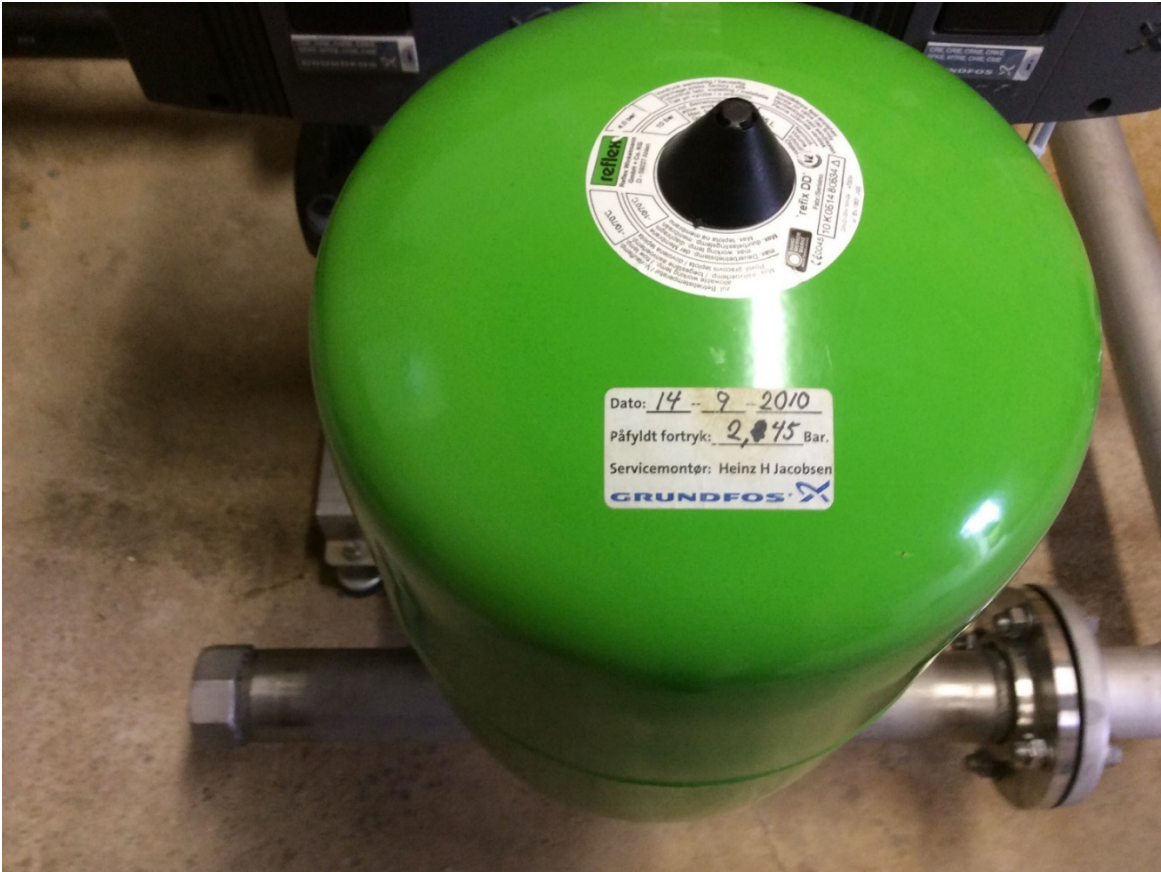
Trykmembranbeholder på udpumpningsanlæg
