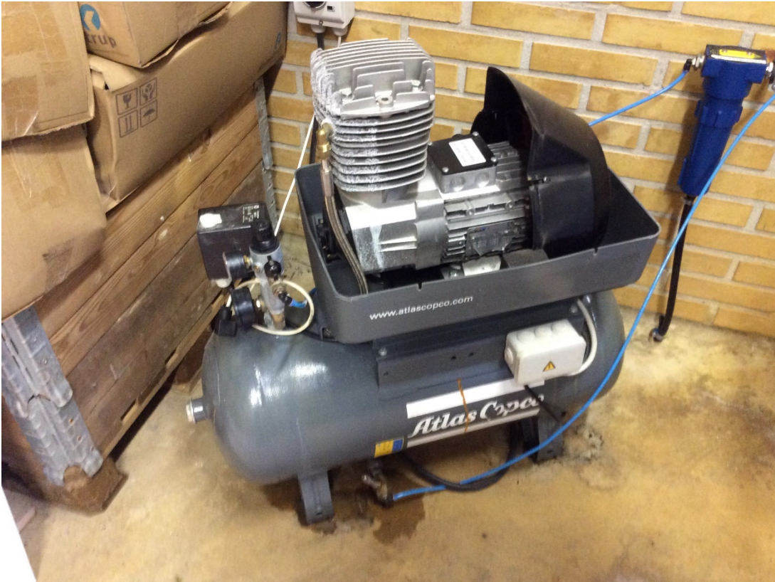
Kompressor til iltning
