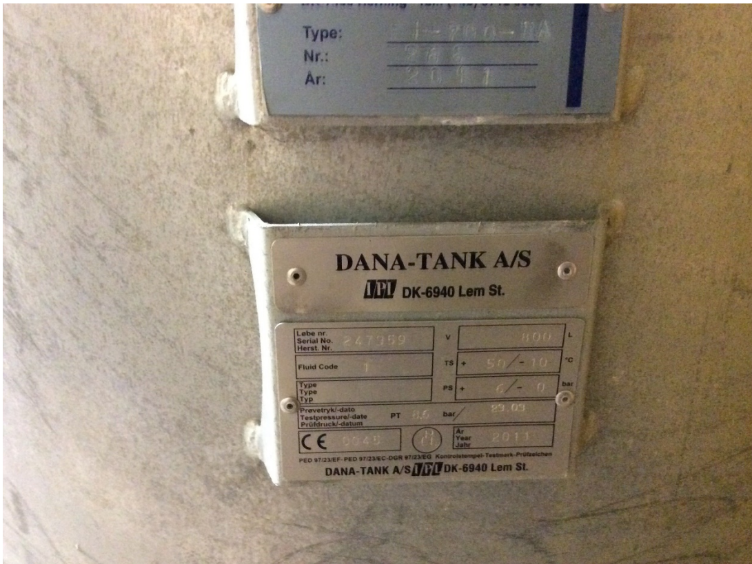
Mærkeplade på trykfilter
