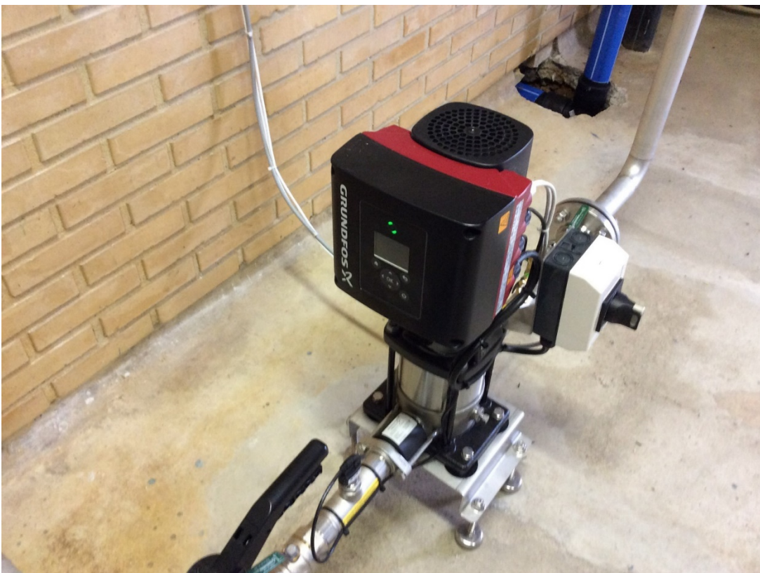
Rentvandspumpe til højzonen
