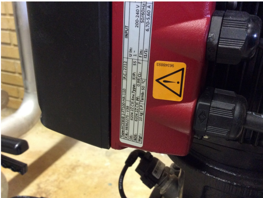
Mærkeplade på rentvandspumpe højzonen
